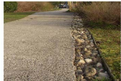
Petite tranchée drainante le long d'un espace piétonnier
